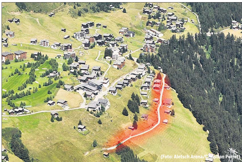
Die «Chummastrasse» (eingefärbt) muss wegen Erosion saniert werden.
