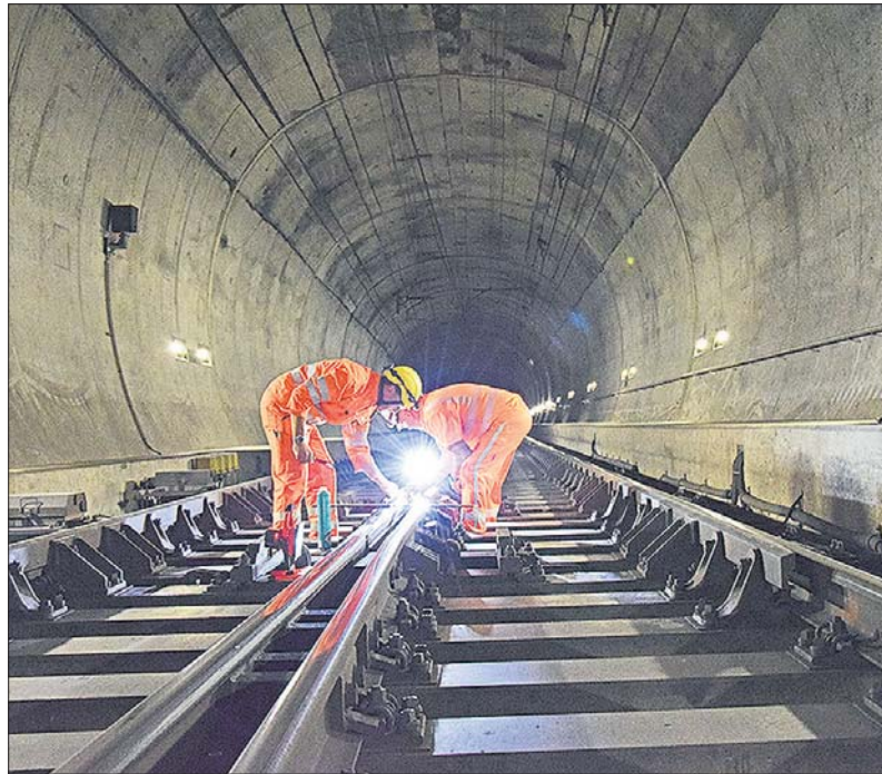
Die Weichen im Lötschberg-Basistunnel werden regelmässig kontrolliert.
