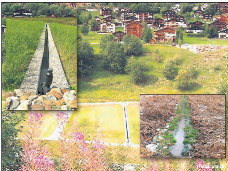
Die WRA Wiler: Zulaufkanäle und Rohre sind verschlammmt (Bild rechts). Links: Laut Erbauer sollte eine optimal gewartete WRA so aussehen.
